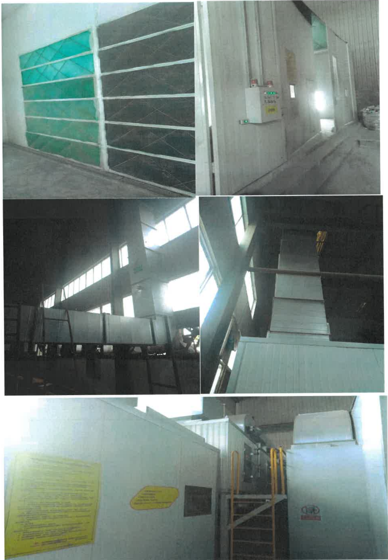
图 5-1 项目刷漆房、喷漆房及相关废气治理设施图
